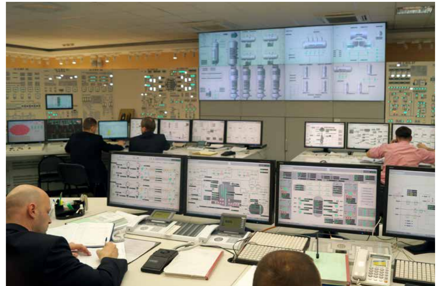
Az üzemelő Novovoronyezs II-1 blokk vezérlőterme Fotó: Hárfás Zsolt
